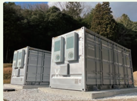
丹波篠山幡路蓄電所
